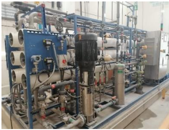
トラスカラ工場の排水処理設備（メキシコ）
