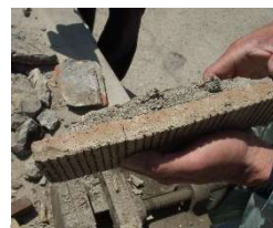
タイル裏足のモルタル
